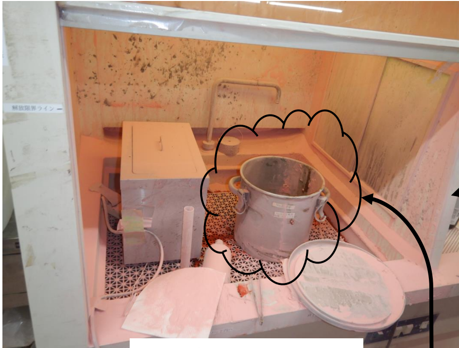
◎フード内写真（発火場所）
